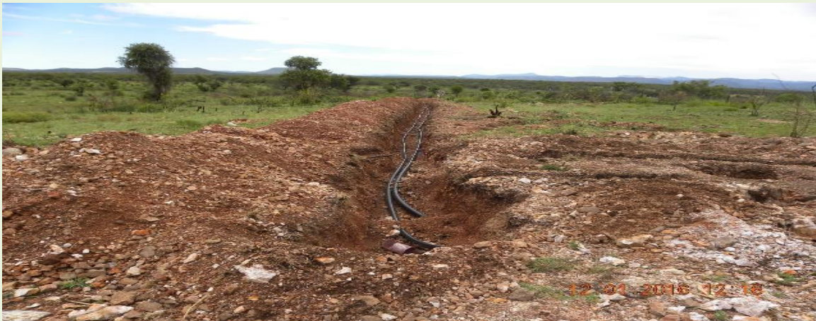
Vingerkraal pump line.
